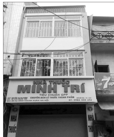
Công trình sai phạm của ông Thủy.
